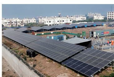
グジャラート工場の太陽光発電設備
