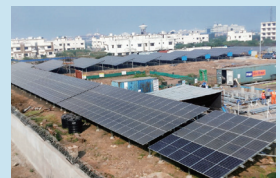
グジャラート工場の太陽光発電設備
