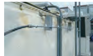
チラー水槽への散水設備
