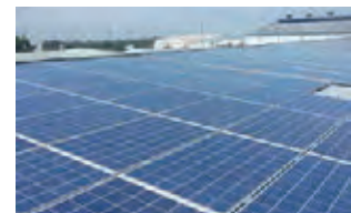
TOYO INK (PHILIPPINES) CO. INC. 工場屋上の太陽光発電設備
