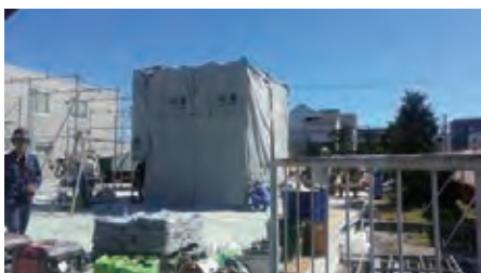
東洋FPP(株)北海道事業所での土壌汚染状況調査 (防音シートで囲ってボーリング調査を実施)
