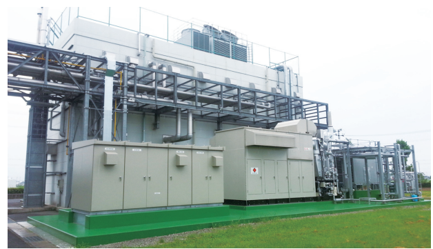
守山製造所のコージェネレーションシステム
