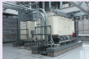
災害用非常電源
