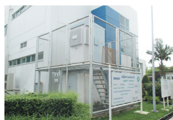
変圧器の浸水対策
