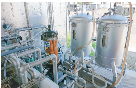
揚水処理装置(東洋FPP(株)北海道事業所)
