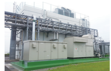
守山製造所のコージェネレーションシステム
