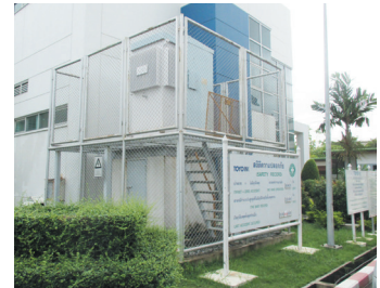
変圧器の浸水対策
