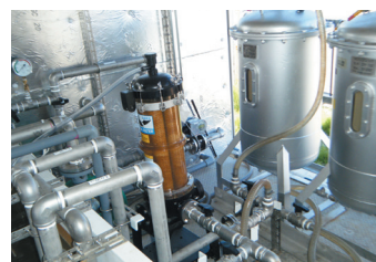
揚水処理設備
