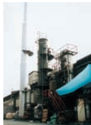
事故の原因となった 焼却炉の排ガス・排水処理施設
