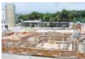
富士製造所で、「リーンバーン天然ガスコージェネレーションシステム」の導入を進めています。(→P23)
