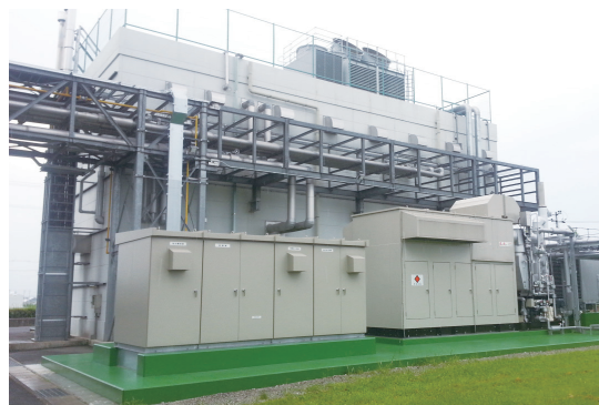
守山製造所のコージェネレーションシステム
