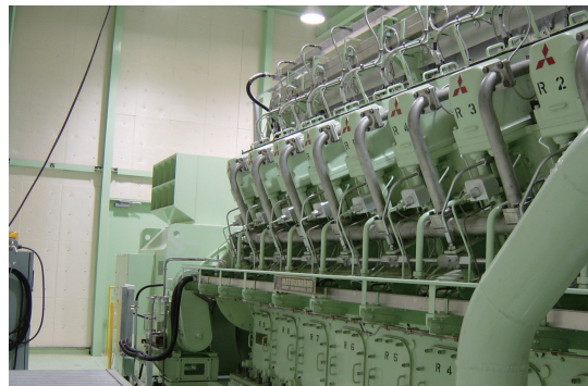
富士製造所のコージェネレーションシステム
