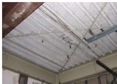
吹きつけアスベストの例
