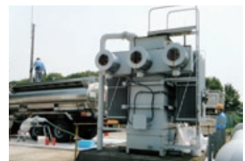
川越製造所における微量PCB絶縁油の処理
