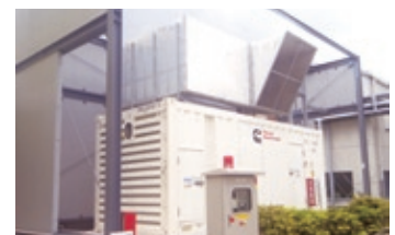
導入した自家発電機
