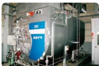
川越製造所の副生液ボイラー
