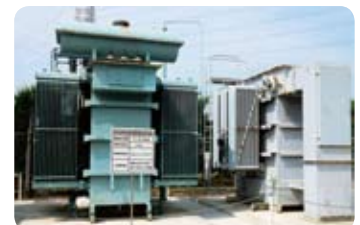
絶縁油抜油後の変圧器(PCB含有機器として保管)
