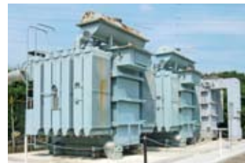
微量PCBを含む絶縁油抜油後の高圧トランス(川越製造所)
