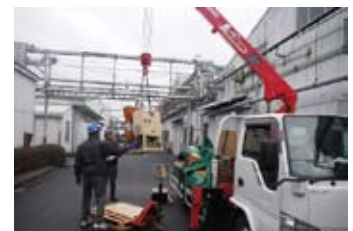
微量PCB廃棄物の処理(守山製造所)
