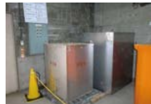
PCB廃棄物の保管状況
