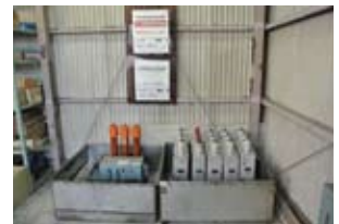
PCB廃棄物の保管状況
