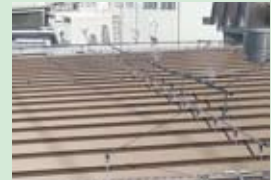
危険物倉庫上の屋根散水システム
