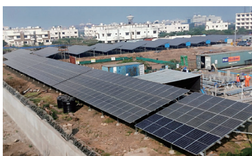
グジャラート工場の太陽光発電設備
