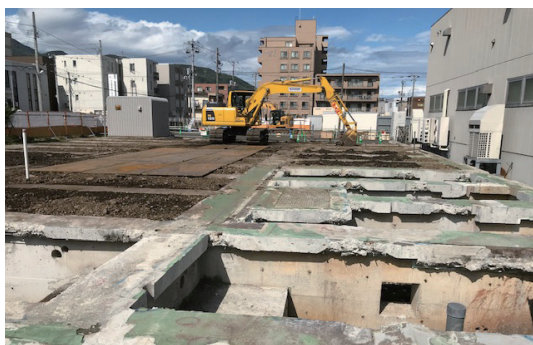
汚染土壌の掘削移動工事の様子(東洋FPP(株)北海道事業所)
